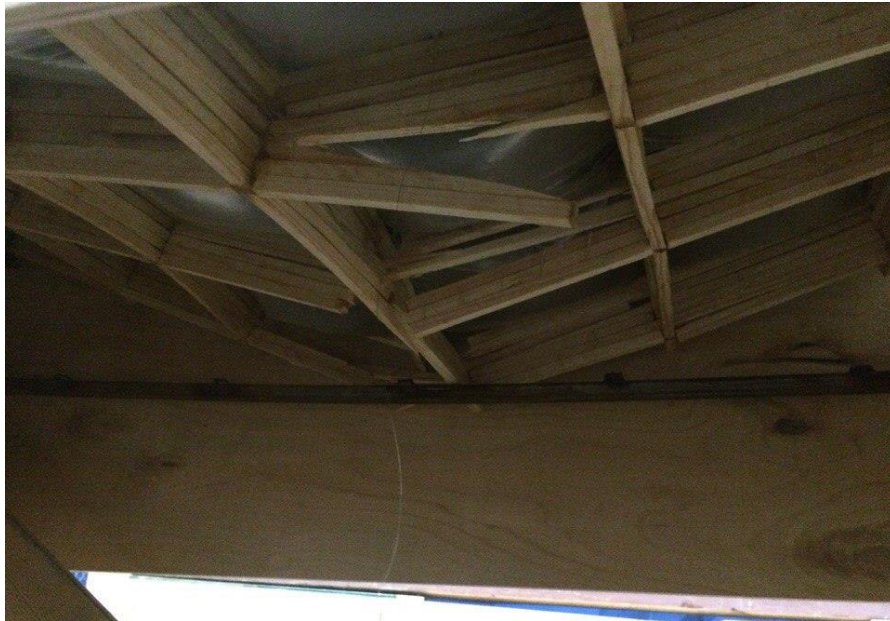
Рисунок47- Разрушение в пролёте
