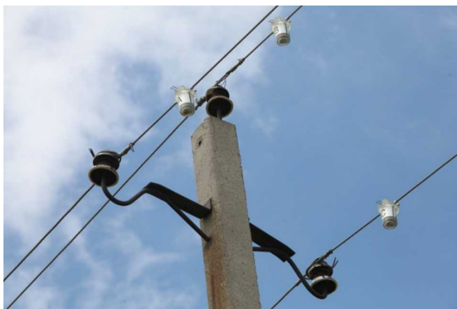
Рисунок 1 – Индикатор короткого замыкания
