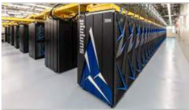
Рис. 2. Суперкомпьютер Summit весит 340 тонн и занимает комнату площадью 860 м 2 . На охлаждение прокачивается 15 тонн воды в минуту. Фото: Национальная лаборатория Ок-Ридж
