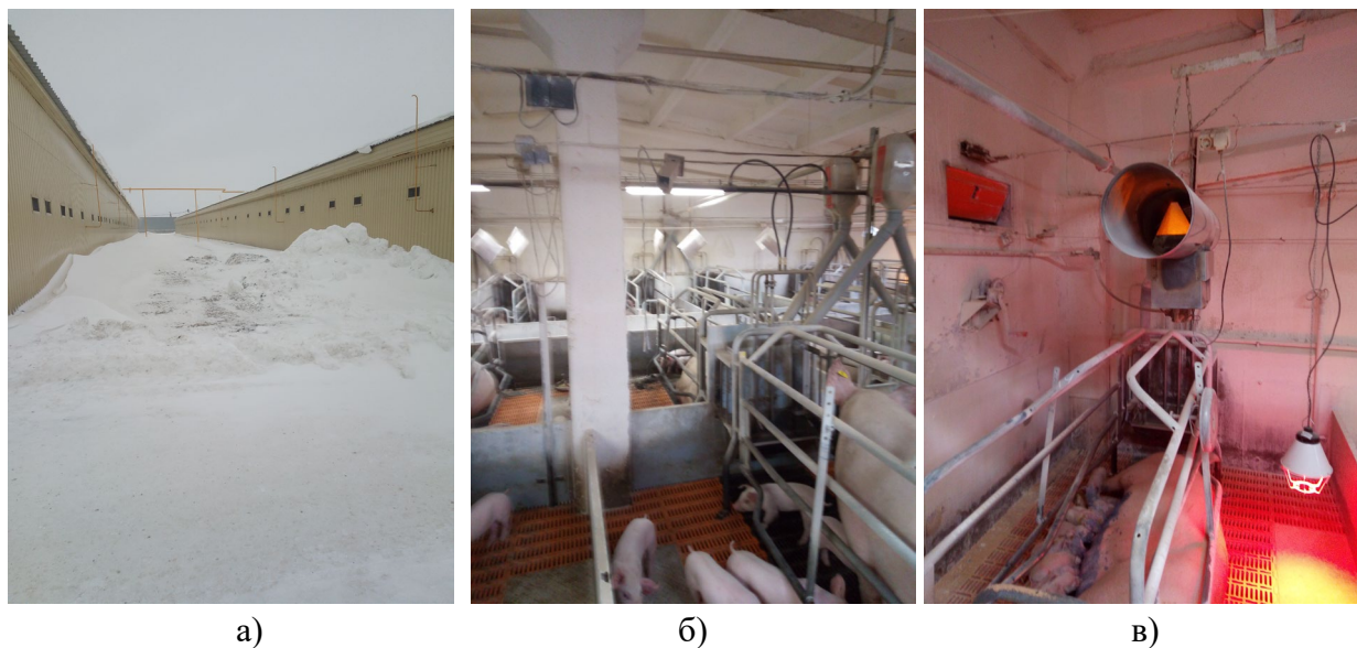
Рис. 1. Приточные каналы для подачи свежего воздуха (а). Датчики микроклимата (б).
